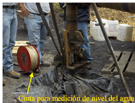
Figura 2. Fotografías que muestran el equipo utilizado en una prueba de bombeo.
