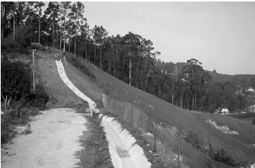
Figura 16.2. Cuneta o zanja perimetral en una explotación minera. Fotografía H. Stockhausen.
