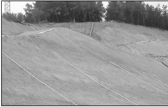
a) con tubos bajantes
