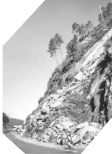
Figura 9.2. Rotura o deslizamiento plano en la carretera entre Monforte de Lemos y Orense. Foto: autores.
