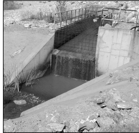
b) Caudal drenado y balsa de decantación
