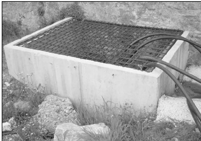
Figura 16.24. Pozo de registro con tubos bajantes de drenes. Fotografía: autores.
